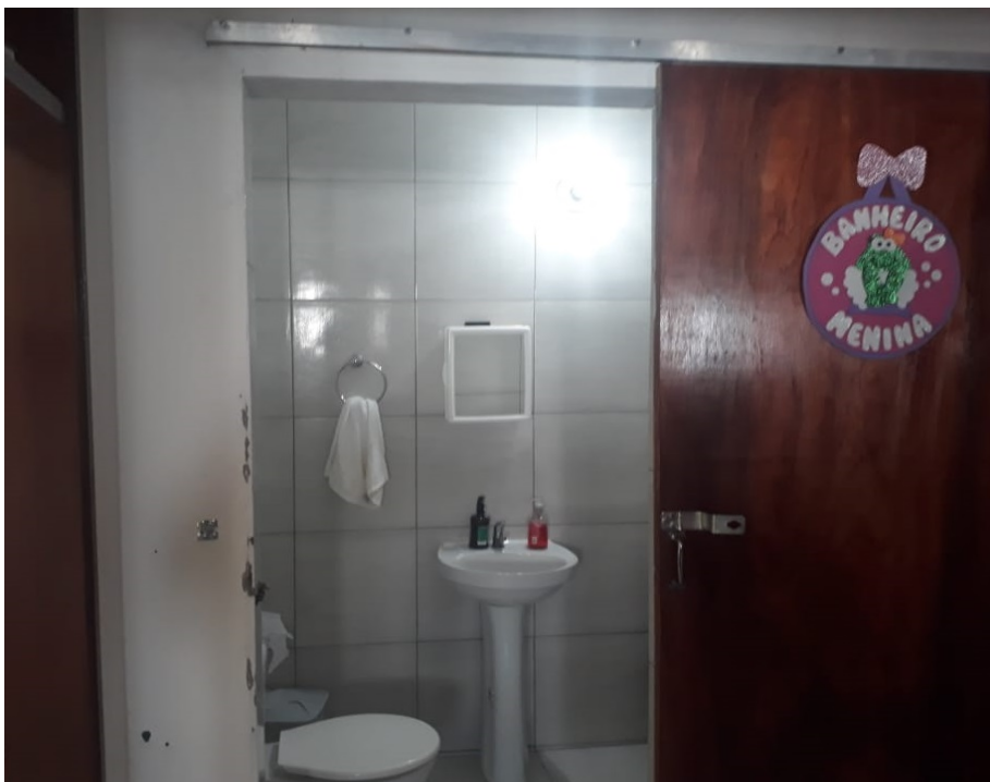
Figura 5: Um dos banheiros com adaptação irregular
